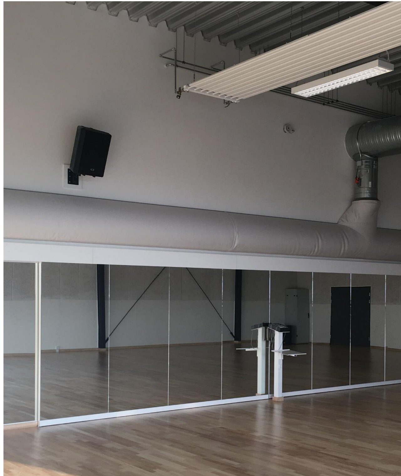
Eksempel på synlige installationer i bevægelsehallen og rytmesal henholdsvis poseventilation, strålevarmeflader og belysning i loft.
