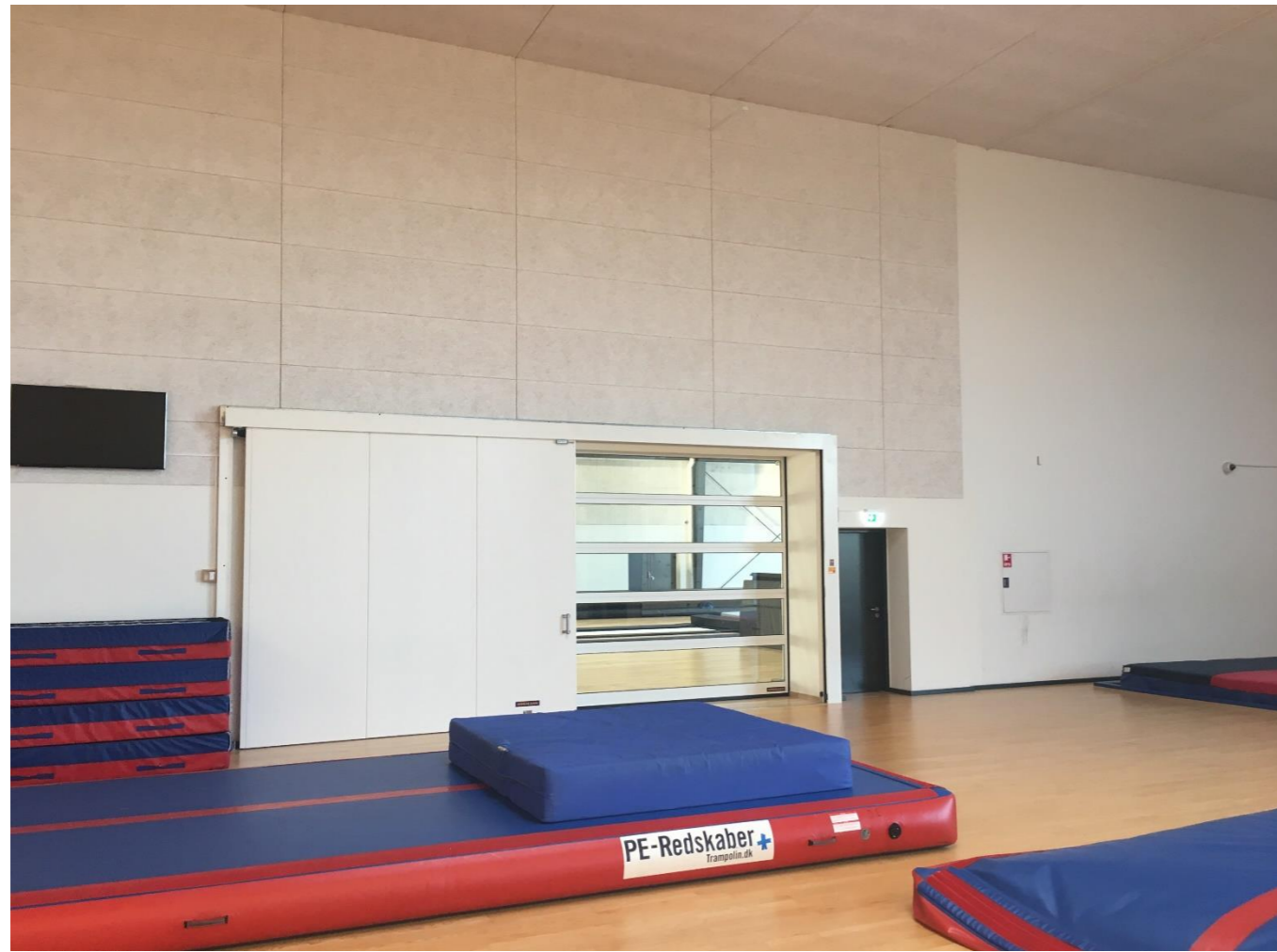
Ydervægge, indvendig side: Udføres som kombination af base i betonsandwichelementer, og en let facadeopbygning bestående af et sandwichpanel (som Paroc) med indvendig beklædning af træbeton (som Troltekt) eller cementspånplade.
